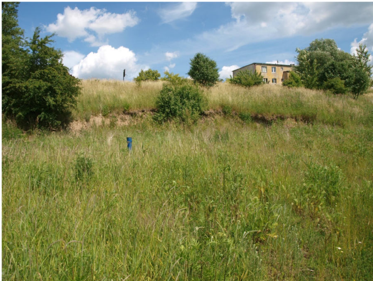
Fot. 1. Wapno. Widok od strony tzw. „gipsiaka”. Widoczne obrywy przy zespole niewielkich zapadliskach widocznych wzdłuż krawędzi dawnego obniżenia po eksploatacji gipsów.
