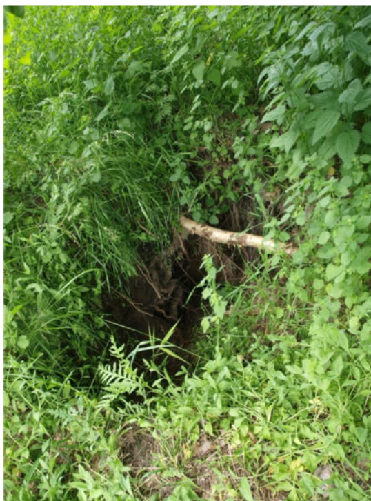
Fot. 3. Niewielkie zapadlisko na wschód od ulicy Solnej w Wapnie. Sierpień 2016 rok.
